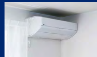
エアコンの運転調整*
